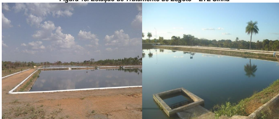
Figura 18. Estação de Tratamento de Esgoto – ETE Sinhá
