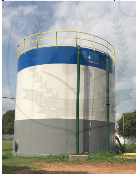
Figura 13. RAP 001 Centro de reservação central
