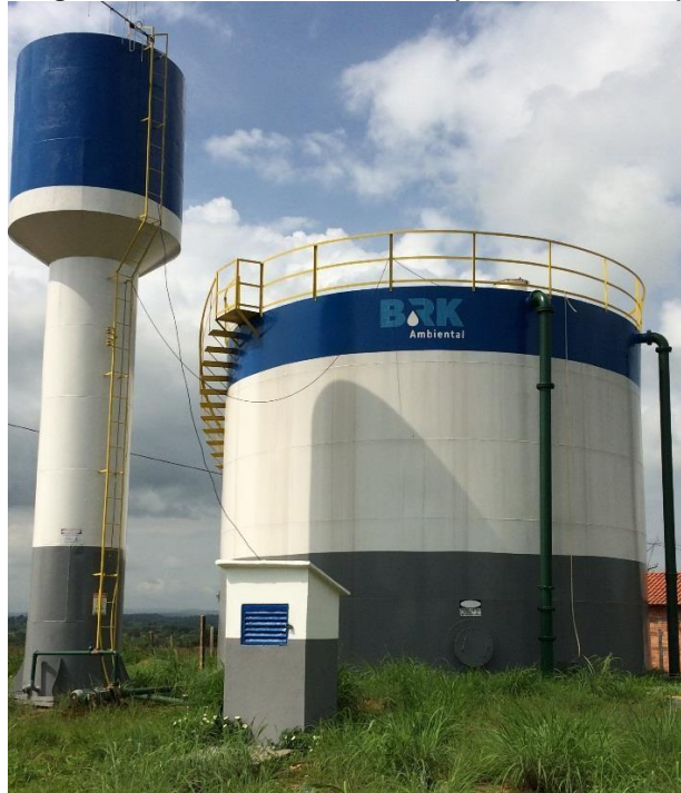
Figura 14. RAP 002 e REL 005 (Setor São João)
