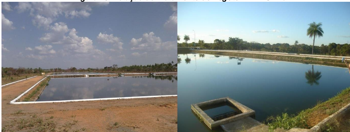
Figura 18. Estação de Tratamento de Esgoto – ETE Sinhá
