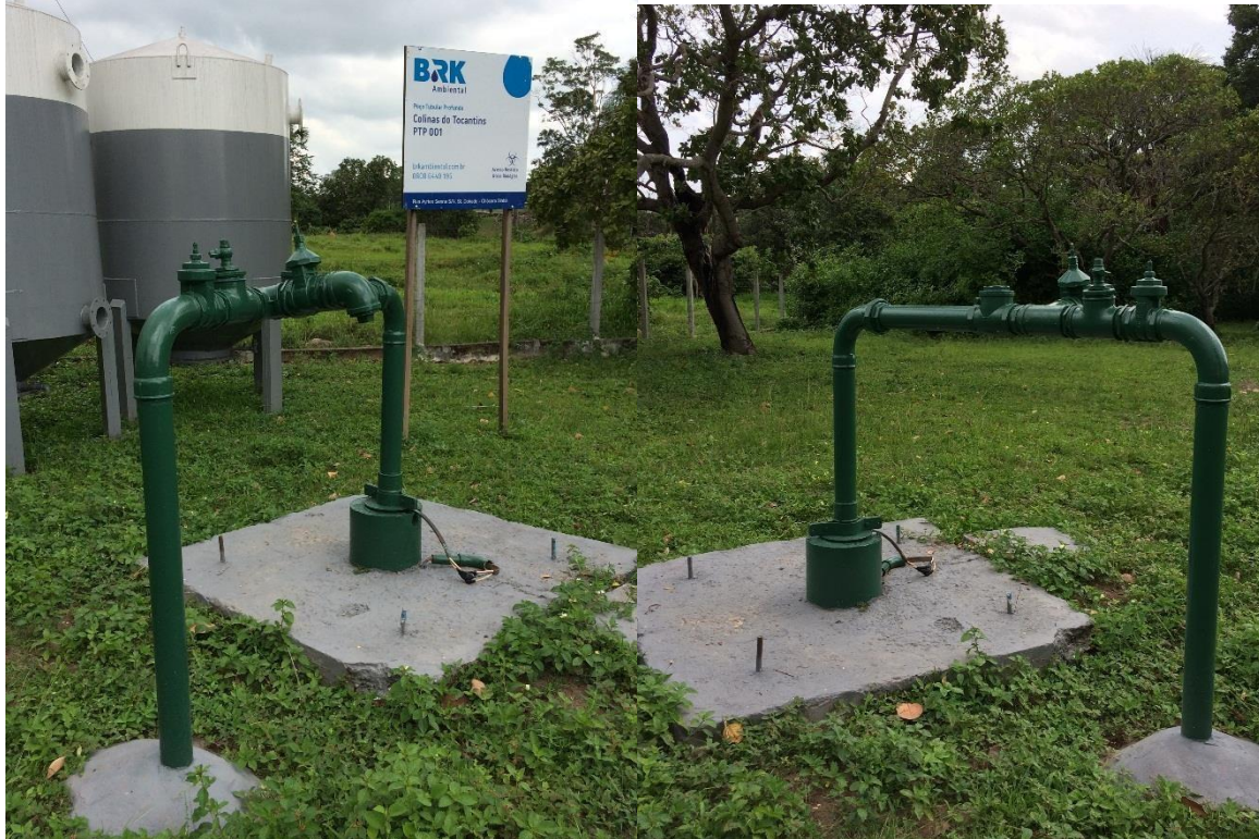
Figura 11. Captação subterrânea – PTP-001 e PTP-002
